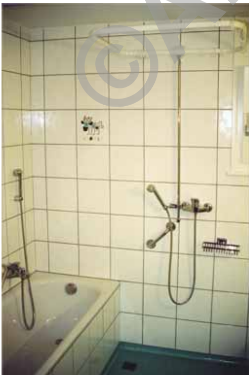
Salle d'eau avec bain et douche
