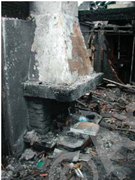
Les combles détruits par le feu
